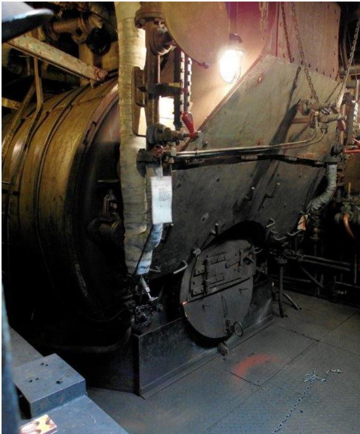
Kessel mit aufgesetztem Schornsteinabzug
